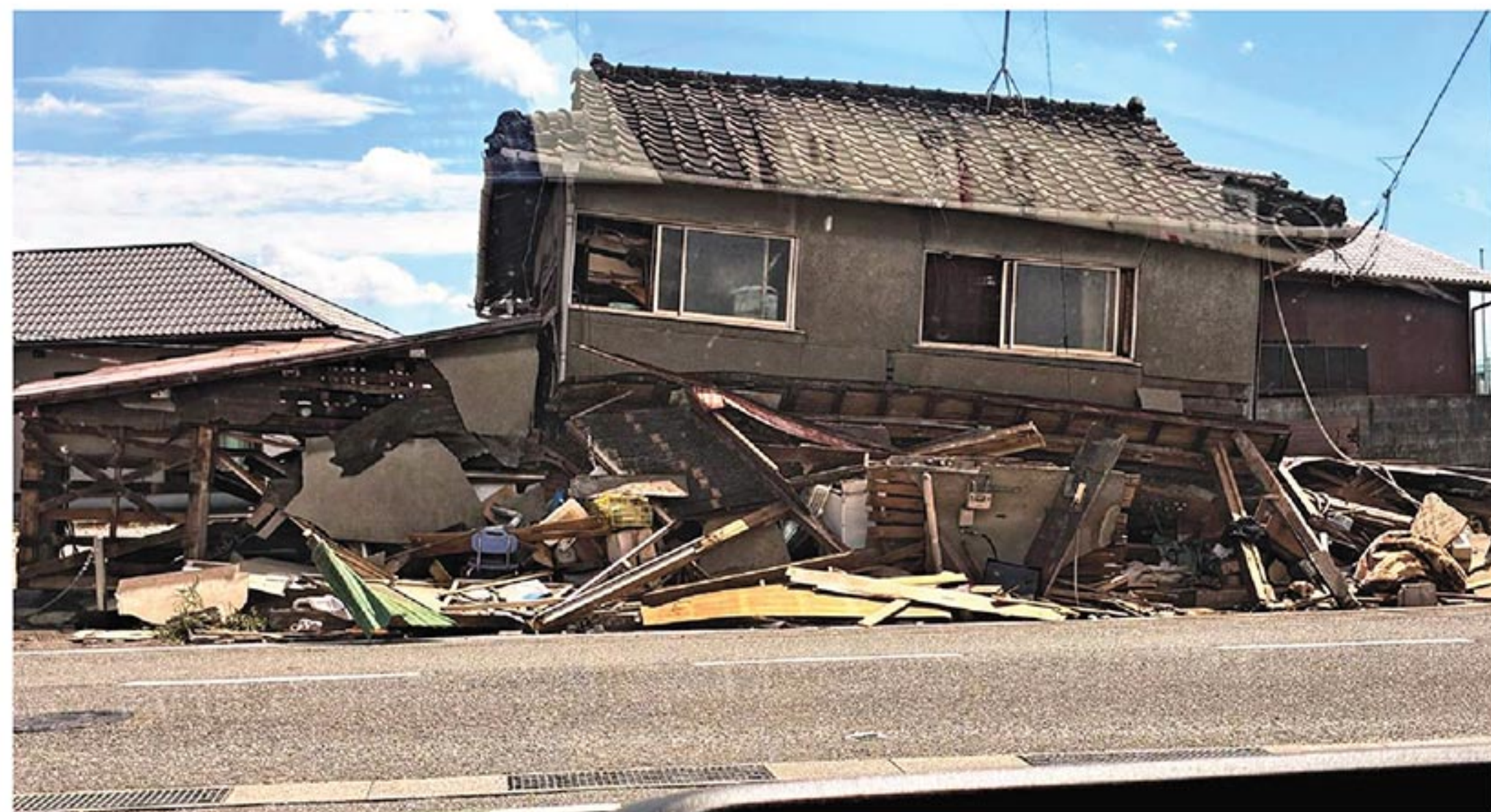
地震により1階がつぶれた家(きょうざれん熊本支部長・福島貴志さん提供)＝29日、熊本県八代市
